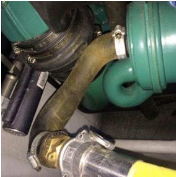
Conexión en el colector de escape
