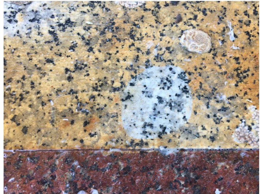
Después de tratamiento con G200 ÓXIDO
