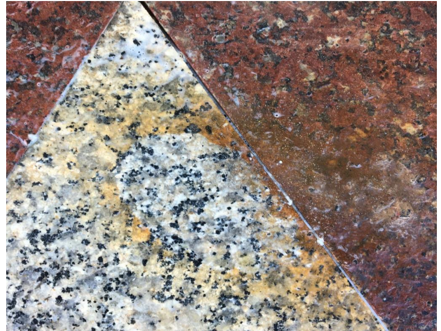
Después de tratamiento con G200 ÓXIDO
