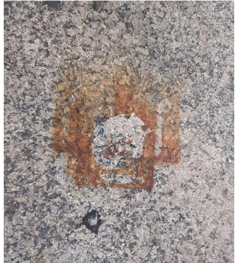
Después de tratamiento con G200 ÓXIDO
