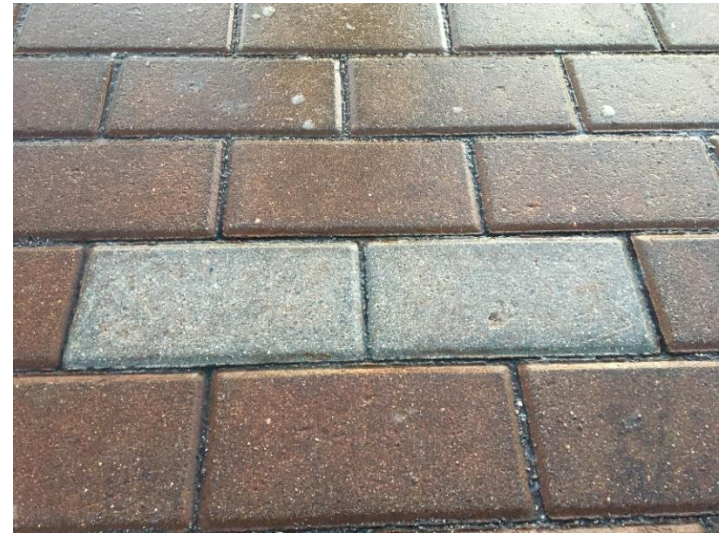
Después de tratamiento con G200 ÓXIDO
