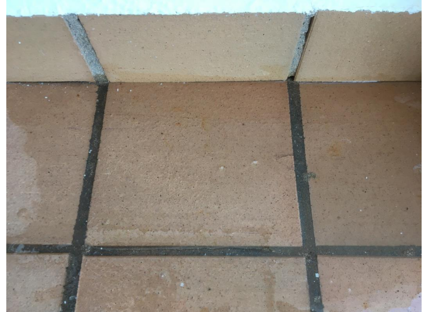
Después de tratamiento con G200 ÓXIDO
