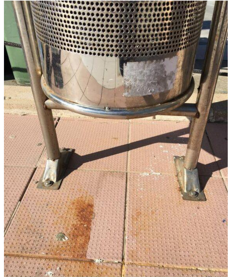
Después de tratamiento con G200 ÓXIDO
