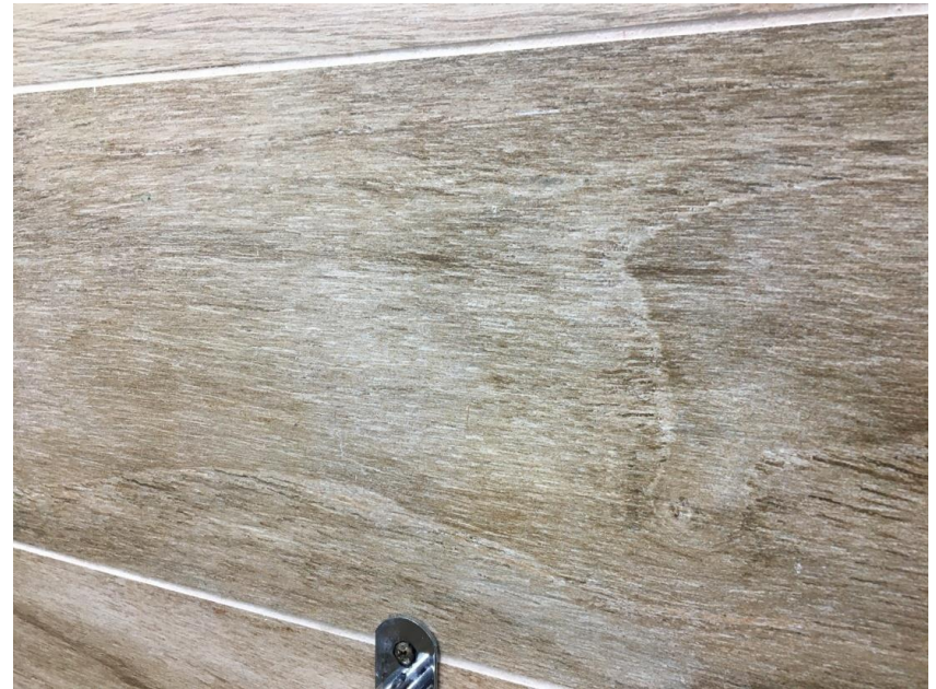
Después de tratamiento con G200 ÓXIDO
