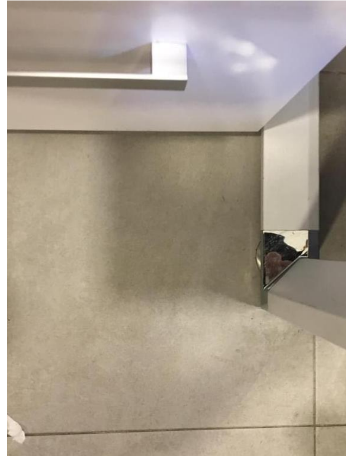
Después de tratamiento con G200 ÓXIDO
