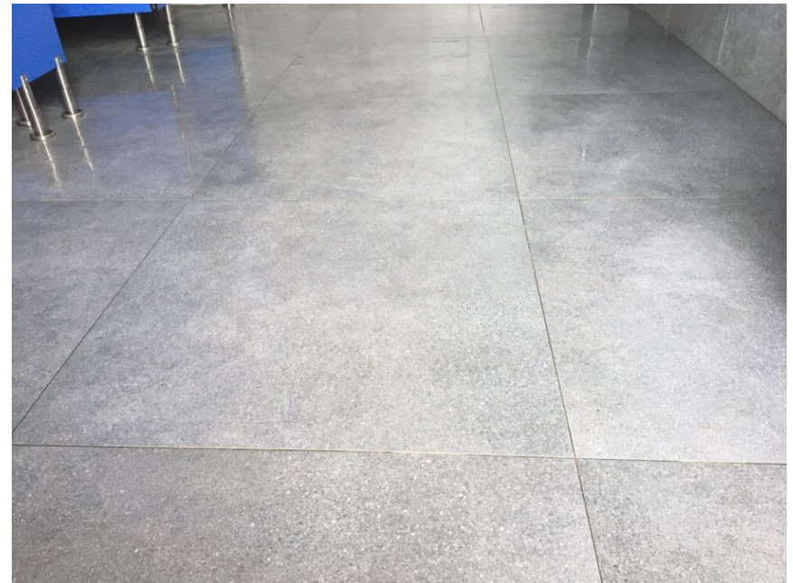
Después de tratamiento con G200 ÓXIDO
