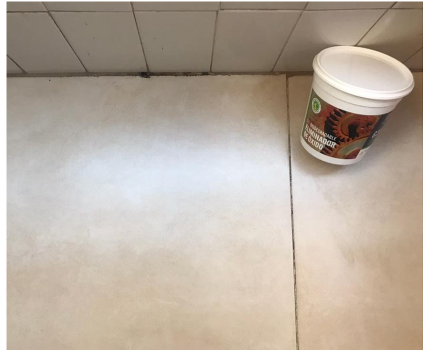
Después de tratamiento con G200 ÓXIDO
