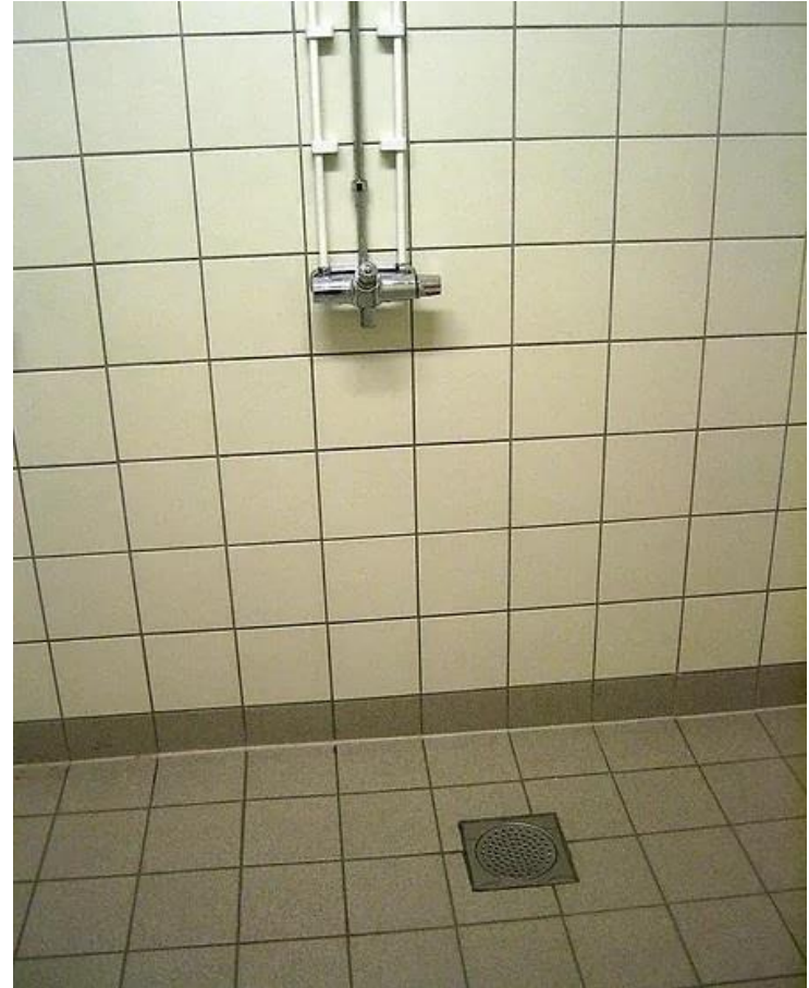
Después de tratamiento con G200 ÓXIDO
