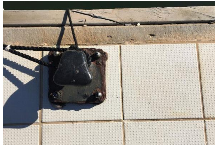
Después de tratamiento con G200 ÓXIDO
